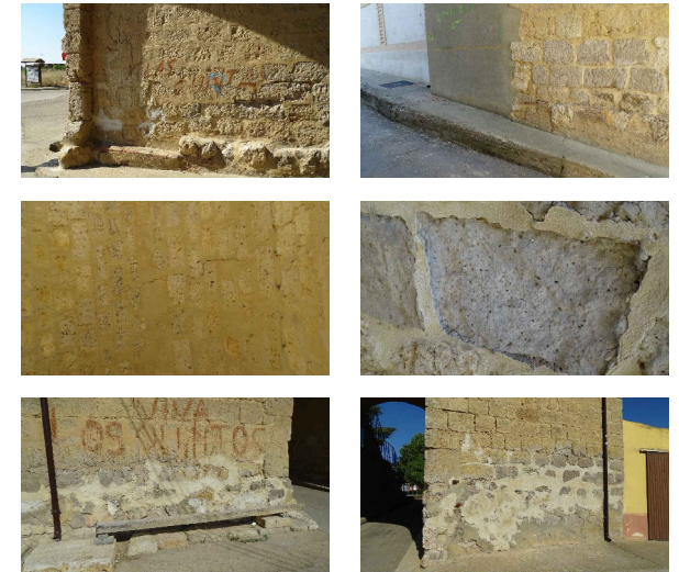
DETALLES DEL ESTADO ACTUAL DE LA PIEDRA
